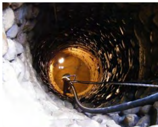
Pozo limpio a conservar en pasillo. FOTO TALACTOR S.L.
